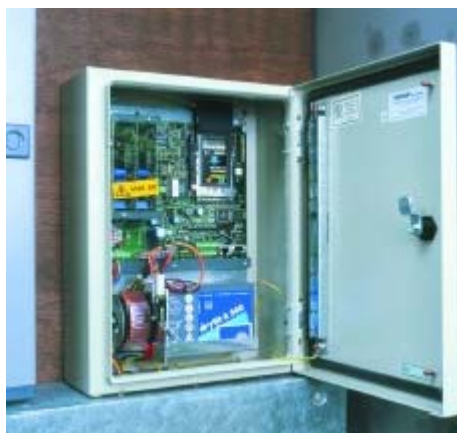
Εικόνα 7.18: Κουτί ελέγχου εγκατάστασης συστήματος διαχείρισης φωτισμού.
