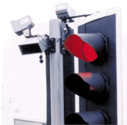
Εικόνα 5.18: Σύστημα ανιχνευτών για ταυτόχρονη κάλυψη πολλαπλών προσβάσεων, τοποθετημένο επάνω στο στύλο του σηματοδότη.
